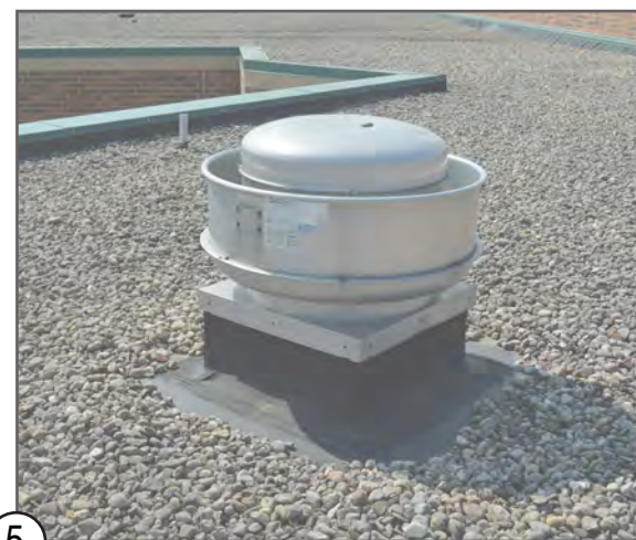
⑤ ROOFTOP FAN
